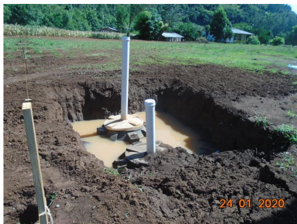
Figura 78 - Fossa séptica e filtro anaeróbico implantado em edificação recente.
