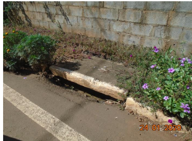
Figura 97 Drenagem pluvial implantada em via pavimentada em asfalto recentemente.
