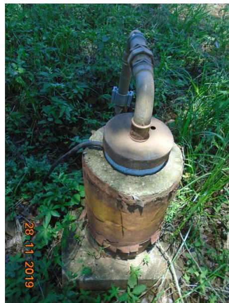
Figura 61 - Poço tubular 09 em detalhe.
