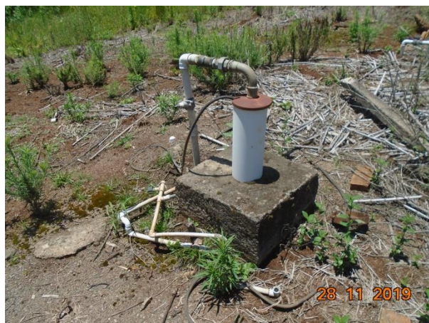
Figura 57 - Em detalhe, poço tubular da Linha Lajeado Bocó
