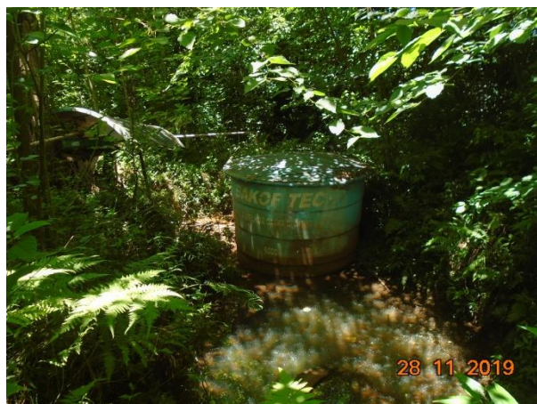
Figura 53 - Em detalhe, ponto de captação de água em nascente
