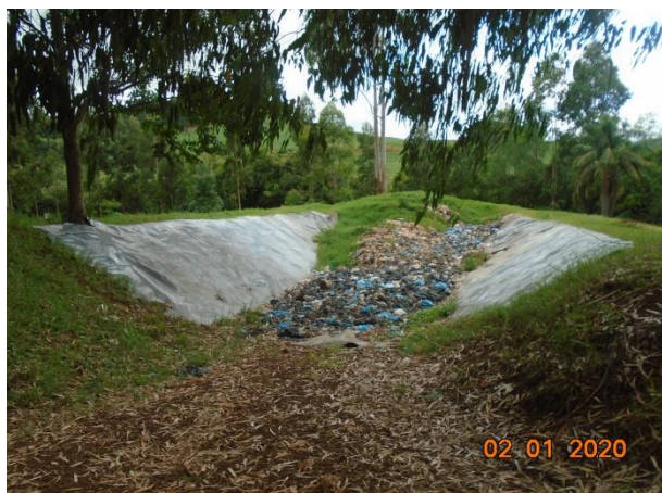
Figura 81 - Vista geral da célula de disposição de resíduos do aterro sanitário municipal.
