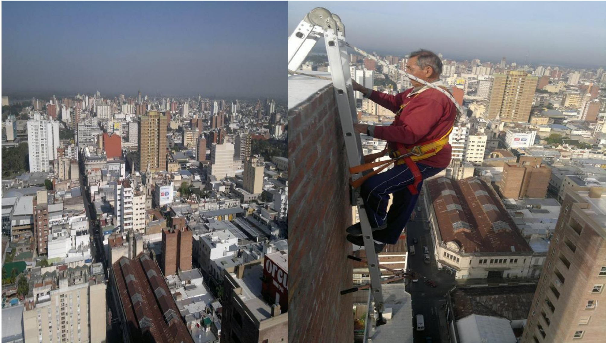
Edificio donde se instalo las antenas, trabajando sin los medios de seguridad – Santa Fe.-
