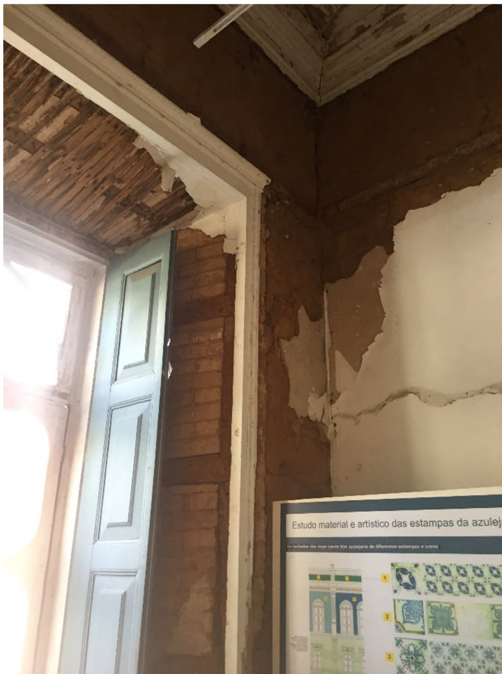
Figura 13: Sobrado do Barão de Itatiba. Detalhe construtivo de uma das paredes construída em taipa de pilão que encontra outra parede construída com a mesma técnica e encamisada com tijolos. Fonte: Thaina Isabela Silva – PUC Campinas.
