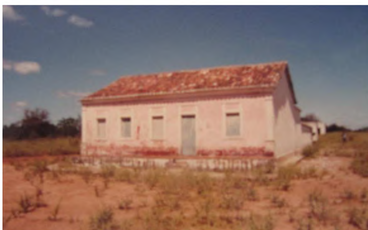
Figura 11: Fachada da sede da Fazenda Morro Branco antes da recuperação. Fotografia: Luiz Freire, 1996.
