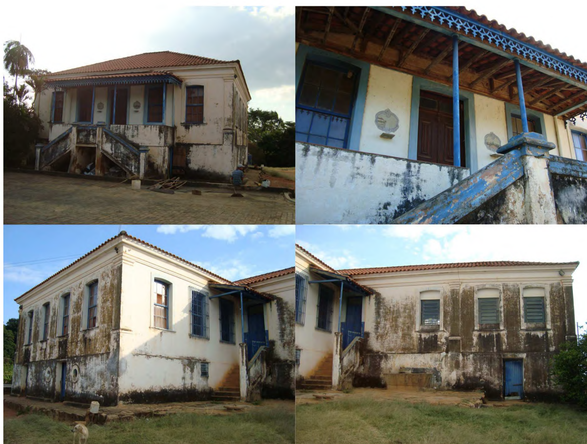
Figura 9: Imagem superior esquerda: fachada frontal que delimita o terreiro de café. Imagem superior direita: detalhe do alpendre, deixando em evidência a estrutura do telhado, os elementos em ferro fundido, novidade para a época, e os lambrequins em madeira. Imagem inferior esquerda: fachada lateral da casa sede, onde vemos o repertório clássico utilizado. Inferior direita: puxado dos fundos e, na extremidade, a ampliação da década de 1920, onde percebe-se que embora as envasaduras tenham sido trocadas por ferro fundido moderno, manteve-se as vergas e pingadeiras. FONTE: Acervo dos autores (2016).
