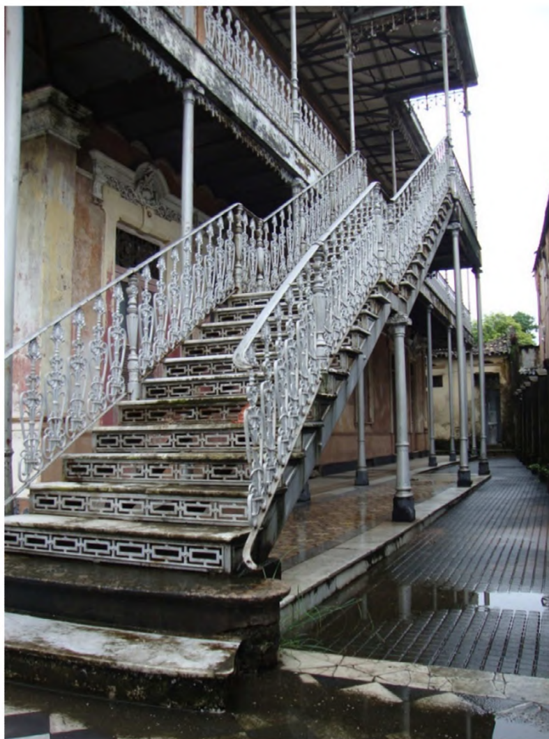
Figura 3: Escada lateral, de acesso ao pavimento nobre. Fonte: Acervo próprio dos autores.
