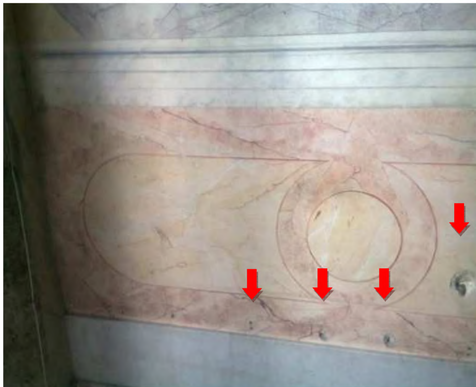
Figura 06 – Perfurações nas paredes com escaiolas. Intervenção feita no casarão em uma das ocupações. Foto: Janaína Lamas Teixeira, 2011 (indicações nossas).
