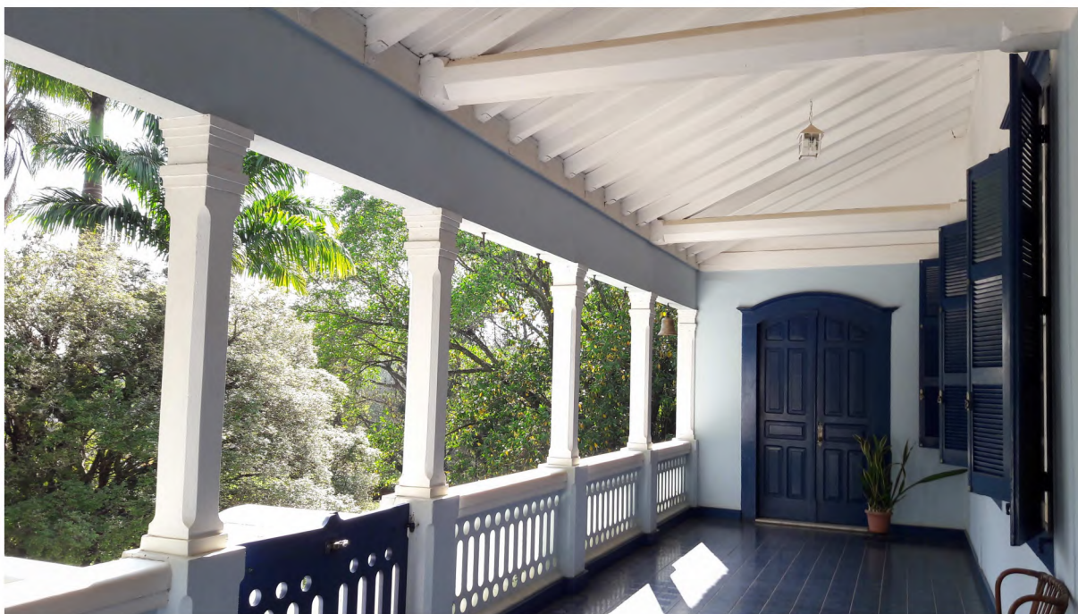
Figura 18: Varanda da Fazenda Bica da Pedra. A estrutura de madeira original foi substituída, no século XX, por vigas e pilares de concreto que sustentam a cobertura, além do piso de ladrilhos que foi adicionado. As envasaduras e todo o madeiramento da cobertura no entanto, foram mantidos. Notar a porta ao fundo, cujo acesso justamente é para o oratório. FONTE: Acervo dos autores (2016).
