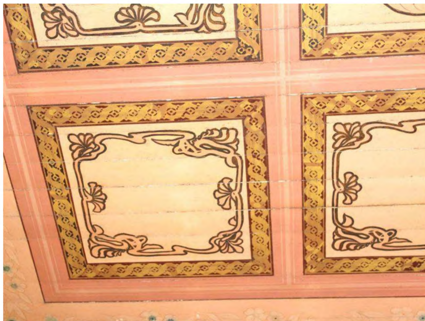
Figura 27: Detalhe da pintura do forro. Fonte: Acervo da autora
