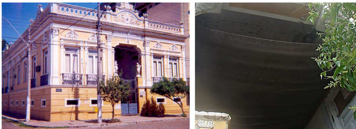
Figura 1 – (E) Fachada da antiga residência de Maria Jacinta Dias de Campos. (D) Aspecto atual do forro de estuque no hall de entrada da residência de Jacinta Dias de Campos. Fonte: fotos de Carlos A. A. Santos, 1997 (E) e 2013 (D).
