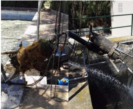
Limpieza bombas balsa agua regenerada
