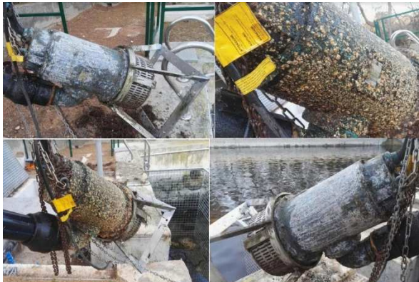
Limpieza bombas balsa agua regenerada
