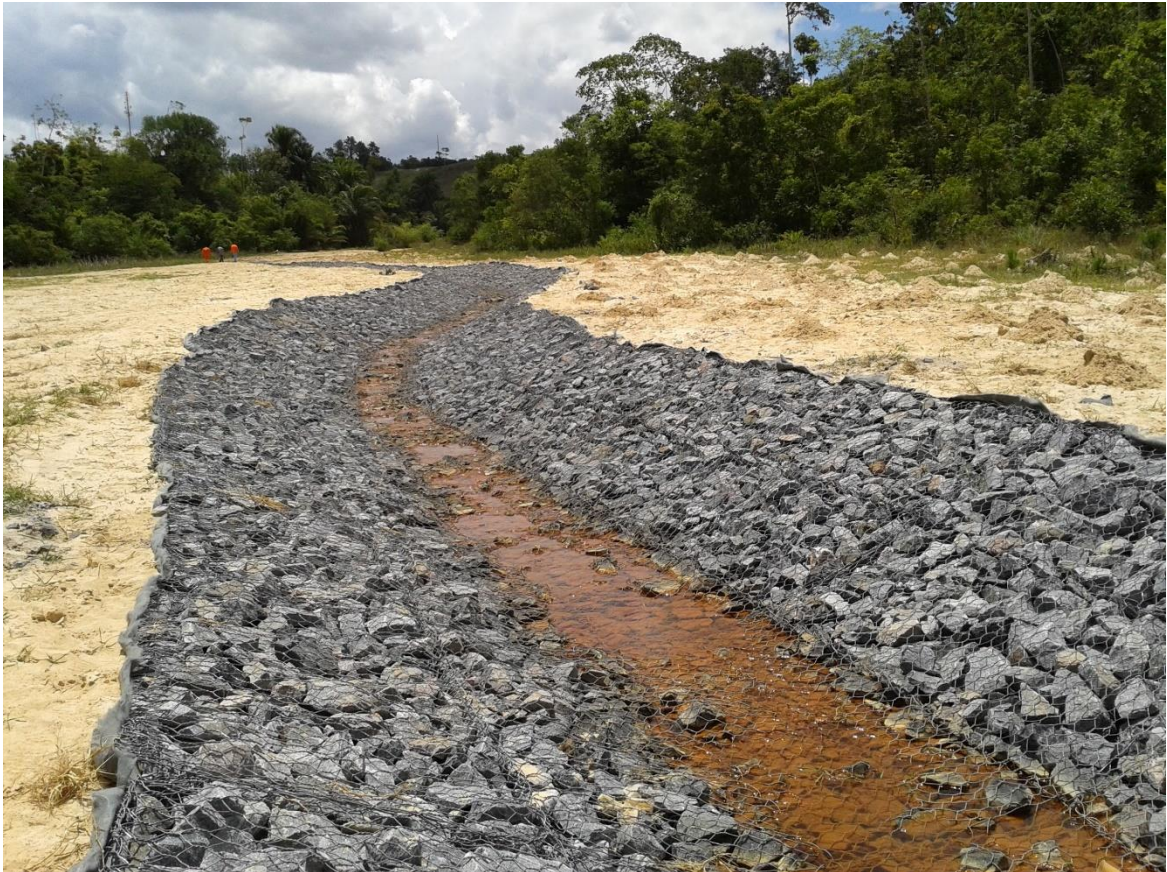
Figura 34 - Exemplo - drenagem reconformada em um canal, evitando a continuação do assoreamento. Local: Recôncavo baiano.
