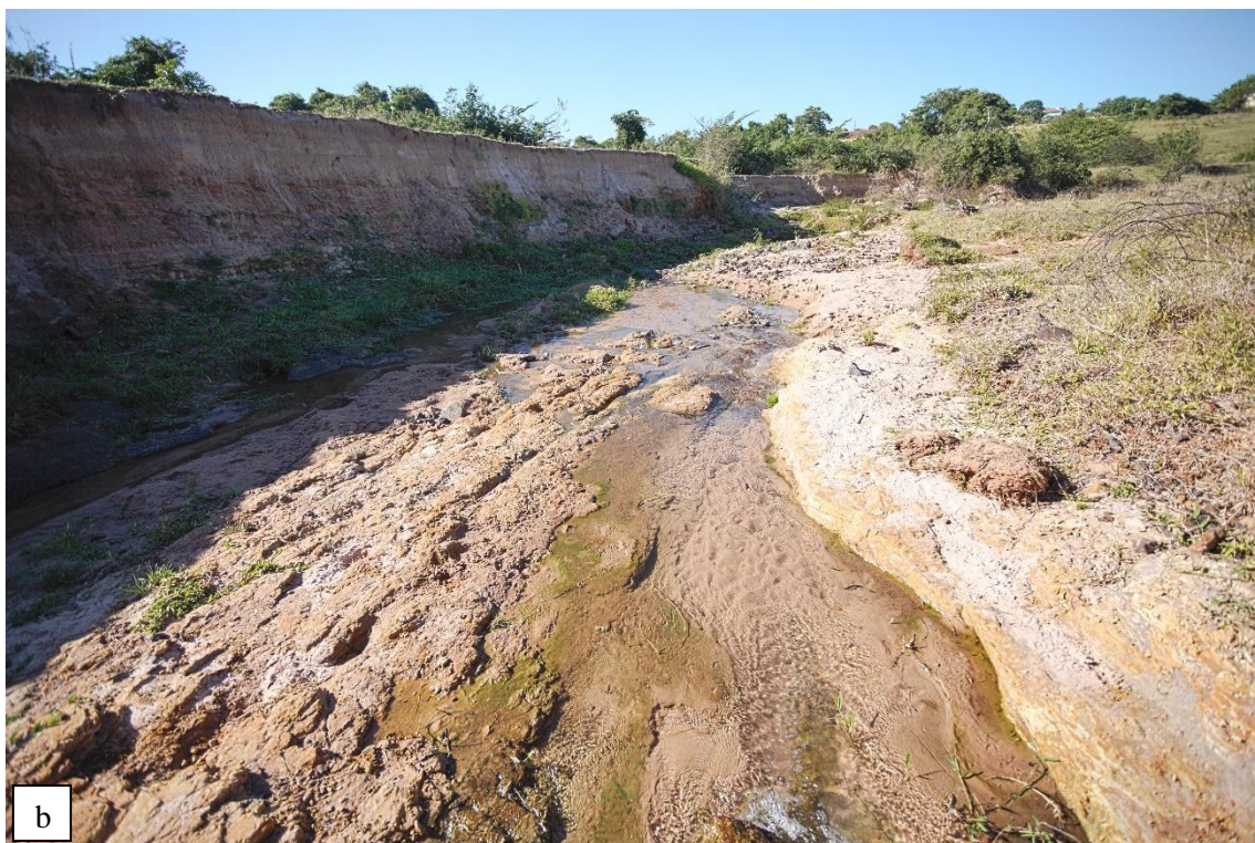
Figura 22 – Sistema de drenagem mal dimensionado (a), ocasionando voçoroca (b). Bacia dos rios Turvo e Grande, 06/2019.
