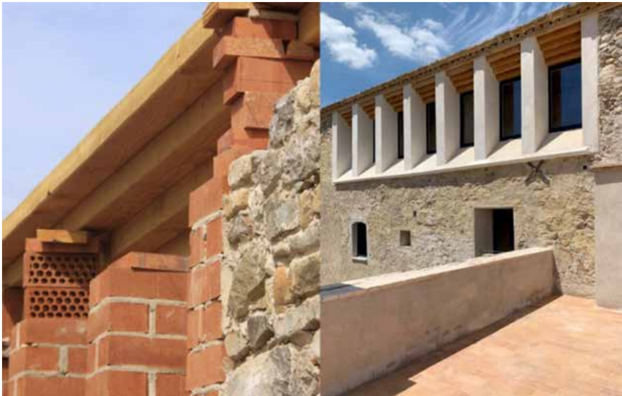
5. Formació d'un gran finestral a la façana migdia en planta sota coberta per gaudir de les vistes, utilitzant el llençatge dels badius per a una òptima contextualització arquitectònica
