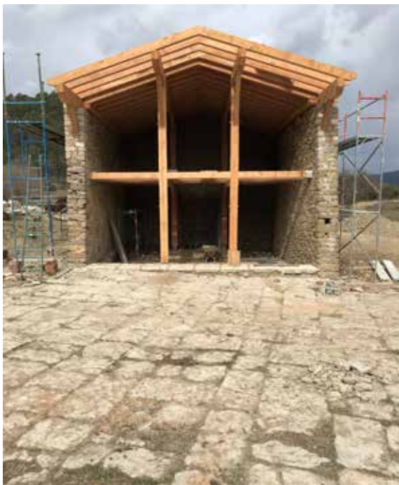
Fase de consolidació murs perimetrals de la pallissa a la tardor del 2018 i estructura de fusta massissa aixecada a l'hivern
