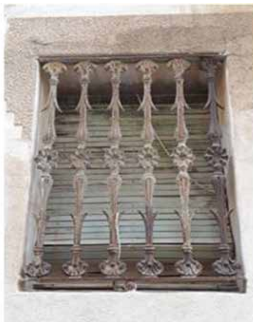
b) Reixa amb brèndoles de fosa, a Darmós, Tarragona (Jornades Tècniques d'Intervenció al Patrimoni 2018).
