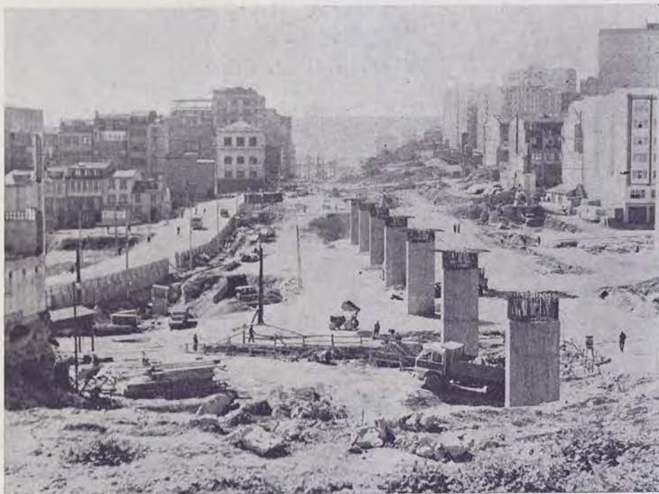
Un paseo por la ciudad coruñesa nos depara continuamente encuentros con la "piqueta". Se trata de las obras de los diferentes sectores de la ciudad afectados por los Polígonos de la Vivienda. Este es el de San Pedro de Mezonzo.
