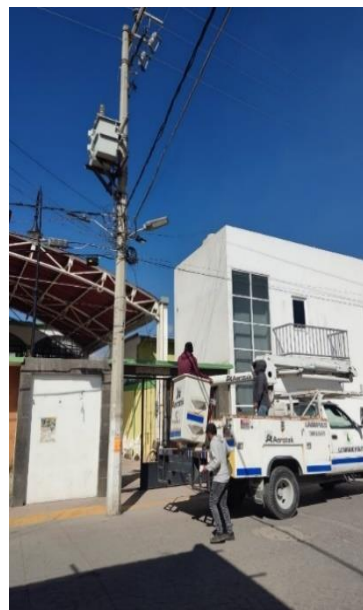
Imagen 82 Mantenimiento de la red de alumbrado público. Fuente: Comunicación Social de Tonanitla, 2022.
