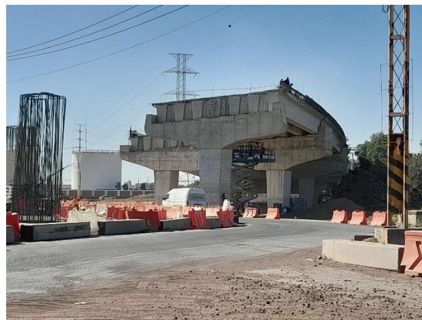
Imagen 83 Obra federal, construcción de paso a desnivel y distribuidor vial en la Av. Gran Canal. Fuente: Comunicación Social de Tonanitla, 2022.
