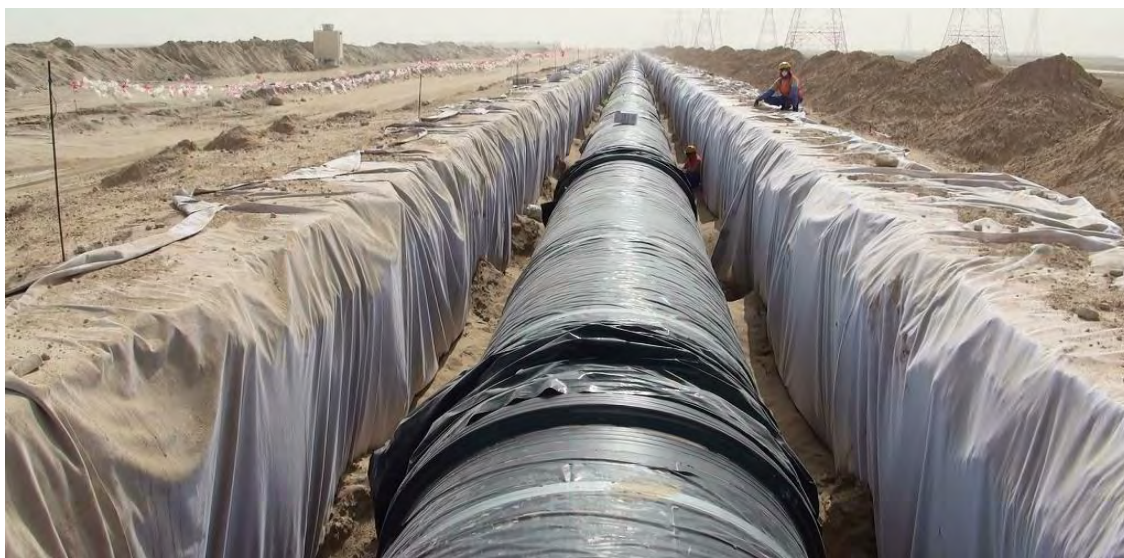
Εικόνα 1: Διαδικασία ελέγχου της κατασκευής ενός αγωγού όλκιμου σιδήρου μήκους περίπου 40 km και διάμετρο 1600 mm, που διανέμει νερό, στην πόλη Musaffah του Αμπού Ντάμπι
