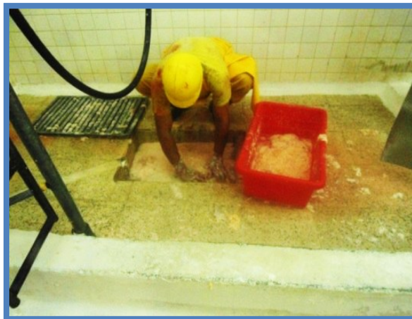
FIGURA N°8: Drenajes de cañerías obstruidos durante los procesos.
