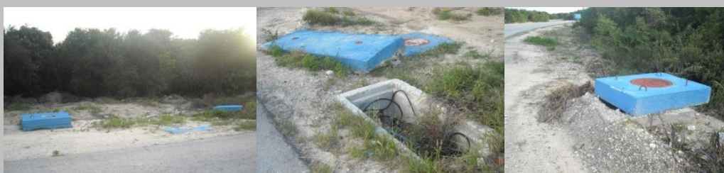
Fotografía 30. Alcantarillado descuidado y con colores poco integrados en el entorno (Fotografías: M. Burgui).
