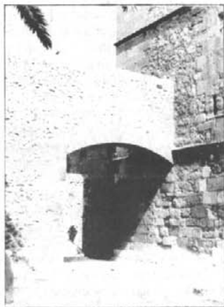
Una de les obres que dugué a terme Bartomeu Tauler fou l'obertura de l'arc del carreró del campanar, l'any 1982
