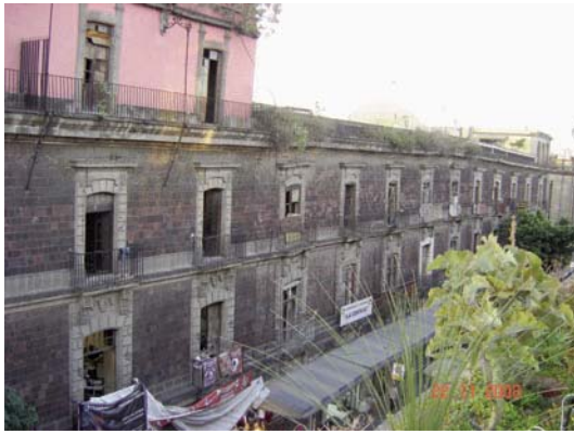
Fig. 12. Deformación de la fachada de un edificio histórico por asientos diferenciales.
