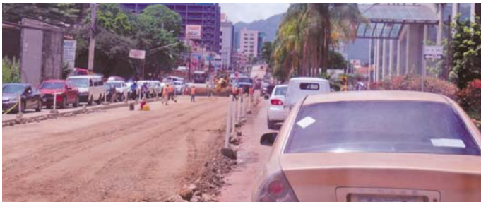
Los conductores lamentan que las obras parecen no avanzar y que las filas de autos que se forman son larguísimas.
