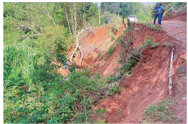
Mucha tubería fue arrastrada por la fuerza arrolladora de las torrenciales lluvias.
