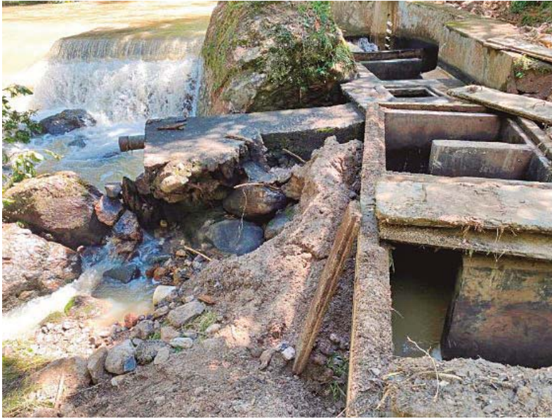
Los daños en el sistema son millonarios por lo que se necesita la ayuda para restablecer el sistema.
