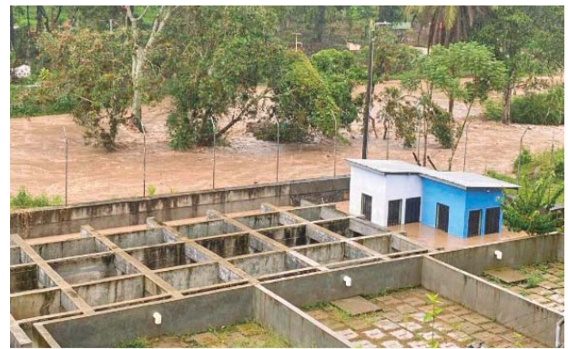
Las instalaciones de Aguas de Marcala resultaron inundadas durante el temporal.
