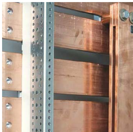
Die Lage der Hauptsammelschienen erhöht die Personensicherheit und sorgt für niedrige Innentemperaturen.
