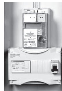
Bild 7: Zählerfeld mit BKE-MARS ZE530 (Nachrüstung)
