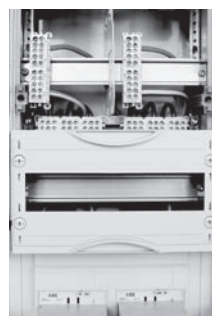
Bild 6: Zählerfeld mit BKE-I
