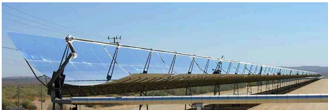
Rysunek 2.11 Paraboliczne zwierciadła wykorzystywane do generowania energii elektrycznej w południowej Kalifornii. Źródło: „kjkolb”/Wikimedia Commons
