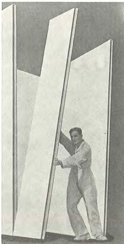
Fig. 169. Gipsvæg fremstillet af plader i etagehøjde og med færdig overflade. (Engelsk vægpanel: Bellrock).
