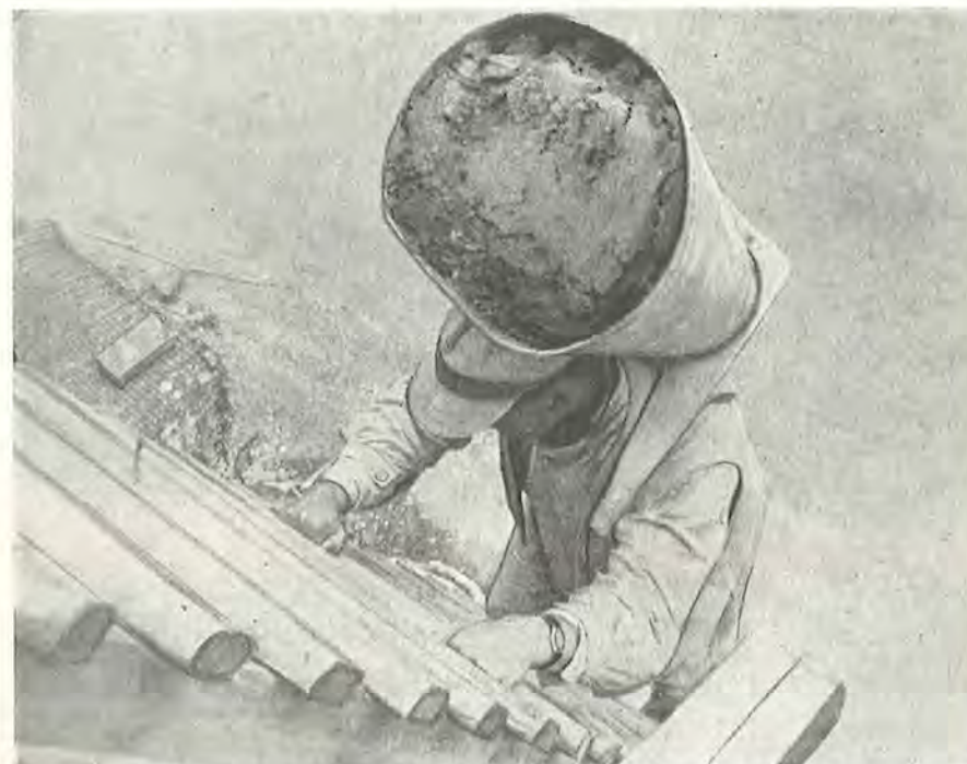
Fig. 5. Scene fra københavnsk byggeplads anno 1953. Det må indrømmes: motivet var svært at finde. For få år siden kunne billedet fås på den nærmeste byggeplads.
