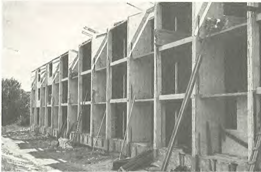
Fig. 122. Bærende, uarmerede tværvægge, 16 cm tykke. Tværvæggene, der springer frem i facaden, er ommurede med gasbetonsten. For at undgå nedbojninger i den slappe pladekant er der indlagt en bjælke på de steder, hvor der kommer stor belastning. Herved brydes det rene pladeforskallingsystem, men for at forenkle forskallingen mest muligt er bjælken, som det ses, lagt opad i forhold til pladen. Det første hus med uarmerede tværvægge opførtes i Hørsholm på forslag af Ishøj. (Lundtofteparken. Entreprenør: Rugård og Willert; Arkitekt: Poul Frederiksen og Arne Poulsen. Rådgivende ingeniør: Hilmar Salmark, Ramboll og Hannemann).
