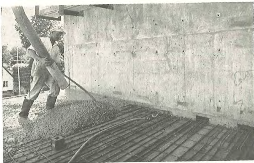
Fig. 172. Etageadskillelse i den på fig. 124 viste bygning, hvor væggene, med udspæringer til fastgørelse af pladerne, først udføres. Et kompliceret afstivningssystem skal stilles op, dækket skal armeres, våd beton skal jævnes og binde af. Det er anderledes hurtigt at lægge et træbjælkelag.
