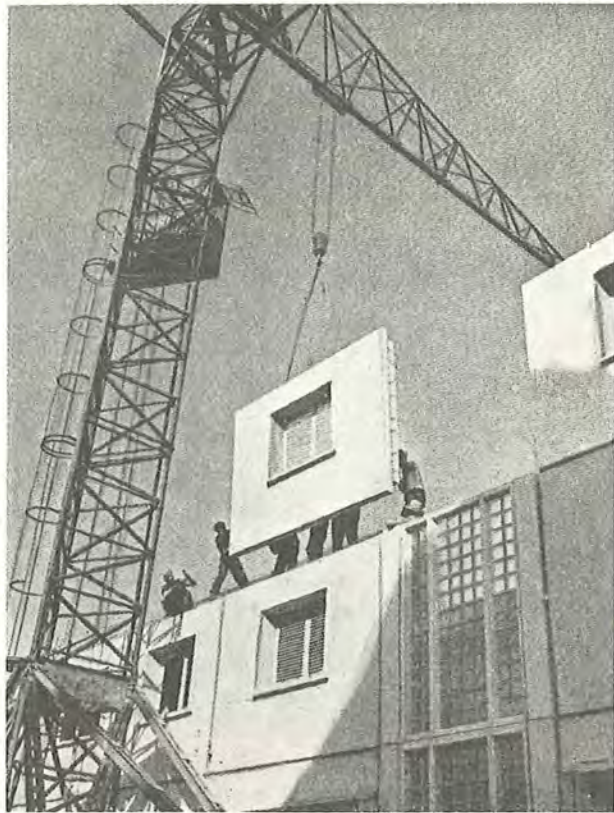
Fig. 149. Disse elementer er fuldstændig færdige, når de er monteret: vinduer med glas, skodder, døre er anbragt, malingen er udført. (System Camus, Le Havre).
