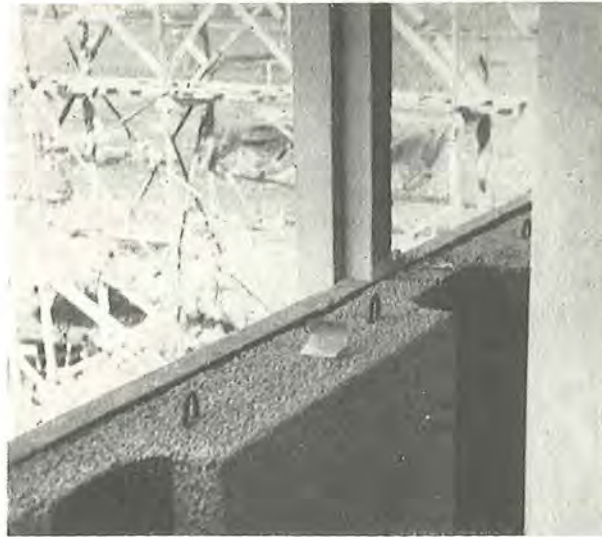
Fig. 160. Brystningspartiet set bagfra. En klinkebetonplade bag den på forrige figur viste brystning klarer varmeisolationen.
