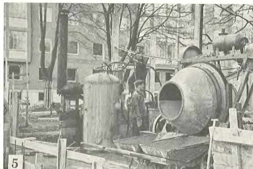
Fig. 24. En dampkedel ell. lign. som kan tilføre betonblendemaskiner varmt vand er uundværlig, når der skal stobes i frostvejr.
