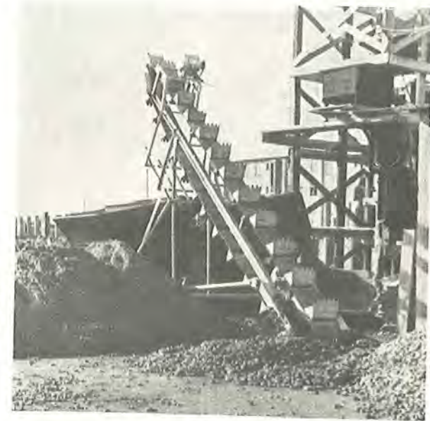
Fig. 45. Lille spandkædemaskine, som forsyner en betonautomats sten- og sandsilo med materialer. (Lundtofteparken, Lyngby. Entreprenør: Johs. Mikkel-sen Sørensen).
