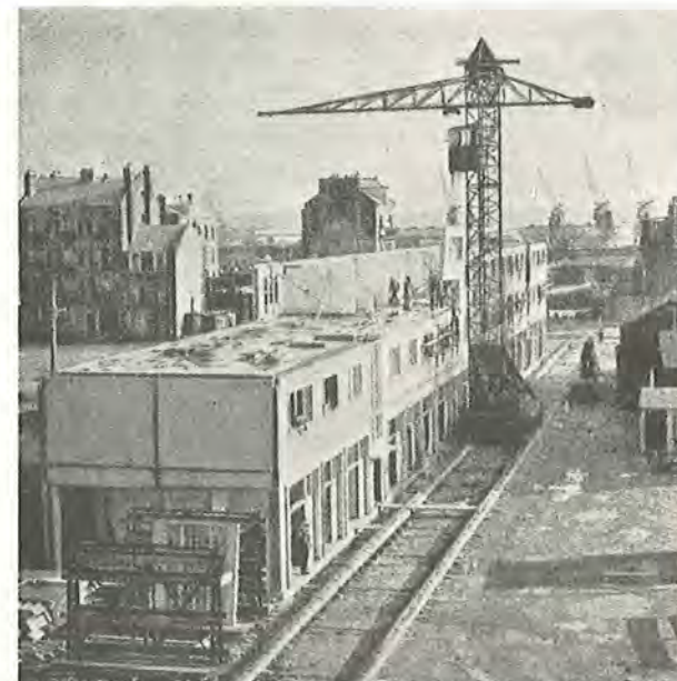
Fig. 31. Dette er den normale placering af en skinnerekørende tårnkran ved et boligbyggeri. Et skinnelegeme er anbragt langs bygningens længdeside, og kranen kan herfra dække hele bygningens areal. Skinnerne skal være solidt understøttede, i reglen på sveller. (Fransk byggeplads).
