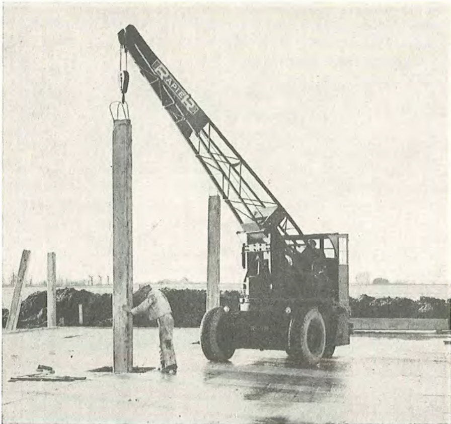
Fig. 40. Svær Rapier-kran beregnet til at transportere byrder, der ikke skal anbringes i store højder. Løfteevne 3 t. (Montering af søjler i garager til hæren. Entreprenør: Manniche & Hartmann).
