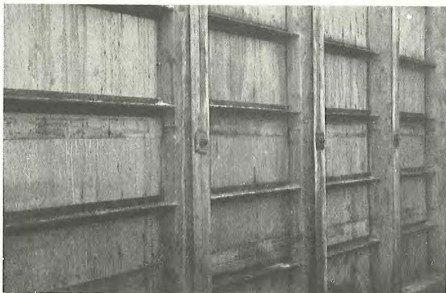
Fig. 127. Forskallingslementer som disse blev første gang her i landet anvendt i en større rækkehusbebyggelse. De er beklædt med vandfast krydsfiner og afstivet med T-profiler. (Rækkehuse, Engstrands allé. Entreprenør: K. L. Larsen og E. C. Pedersen. Arkitekt: Eske Kristensen. Rådgivende ingeniør: P. Malmström).
