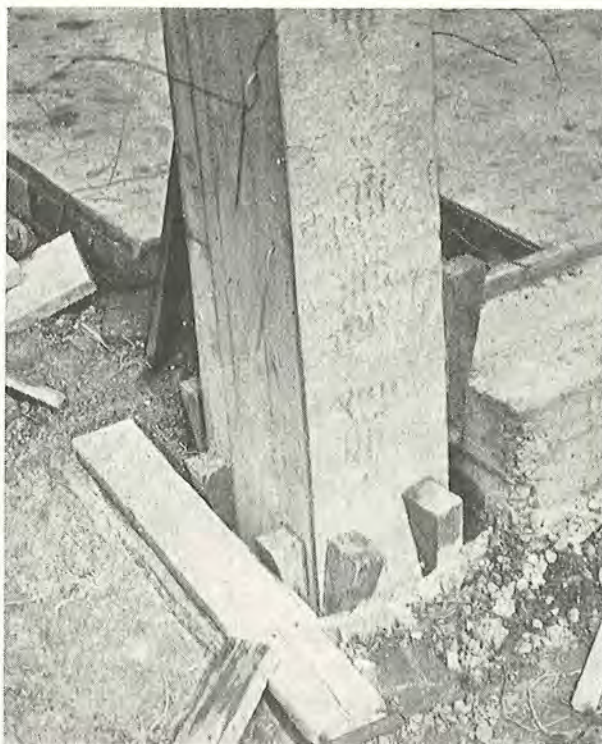
Fig. 94. Søjle fikseret ved hjælp af kiler. Kranen må vente, til søjlen er bragt i rigtig stilling.
