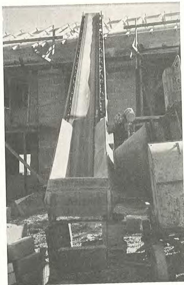
Fig. 46. Transportbånd benyttes til befordring af beton til udstøbningsstedet i dæk over 1. sal. (Tysk byggeplads).
