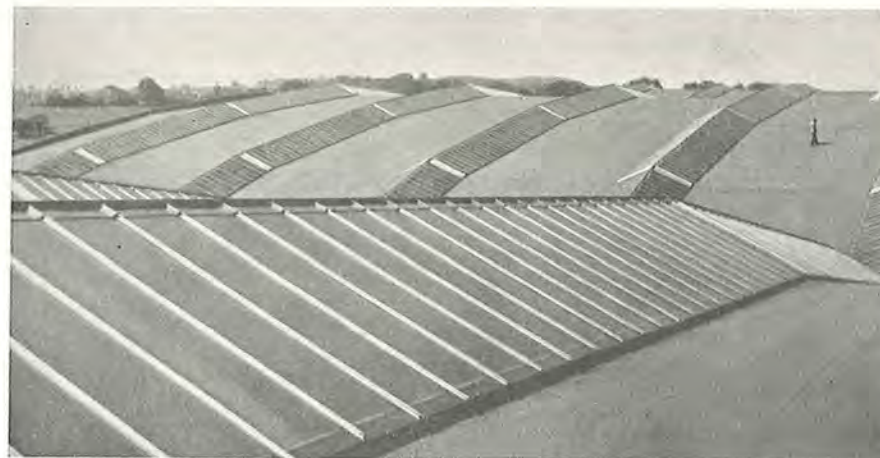
Fig. 112. Sprosserne i dette vældige ovenlys er udført af aluminium. Der var nok at gøre for en maler, hvis de var udført i stål. (Fra samme bygning som vist på fig. 110).
