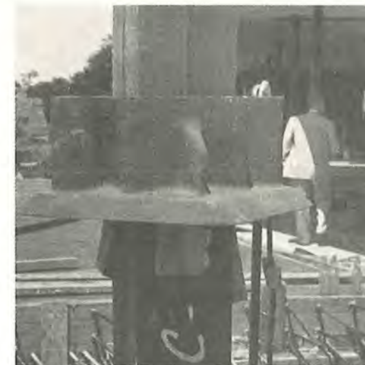
Fig. 190. I lift-slab metoden udgør hele etagepladen et eneste dækelement. Pladerne støbes ovenpå hinanden på det nederste betongulv og hejses efterhånden op langs nogle stål søjler, se øverste billede. De udragende armeringsjern i betonpladernes sidebegrænsning viser, at i det mindste 2 dæk er færdigstøbt. I hver plade er ved alle stål søjler indstøbt en stålkrave, se nederste billede, som svejses eller boltes på søjlerne, når etagepladen er hejst op i sin endelige stilling.
