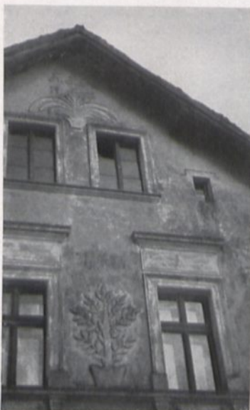
Abb. 6: Dieser Bauernhausgiebel aus Lobnau, Kreis Cosel, zeigt, wie weit um 1912 Handwerk und sinnbildlicher Schmuck in Verfall geraten sind
