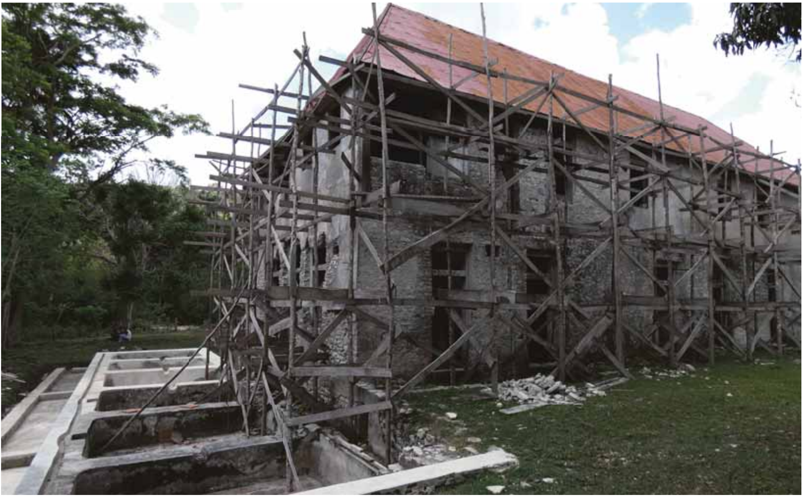
La Fraternidad en cours de restauration. L'énorme chantier de cette cafétal aura pris plus de cinq ans. L'ensemble, maison et jardins, a été inauguré en juillet 2019.
