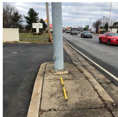
PAR obstruction along southbound US 202
