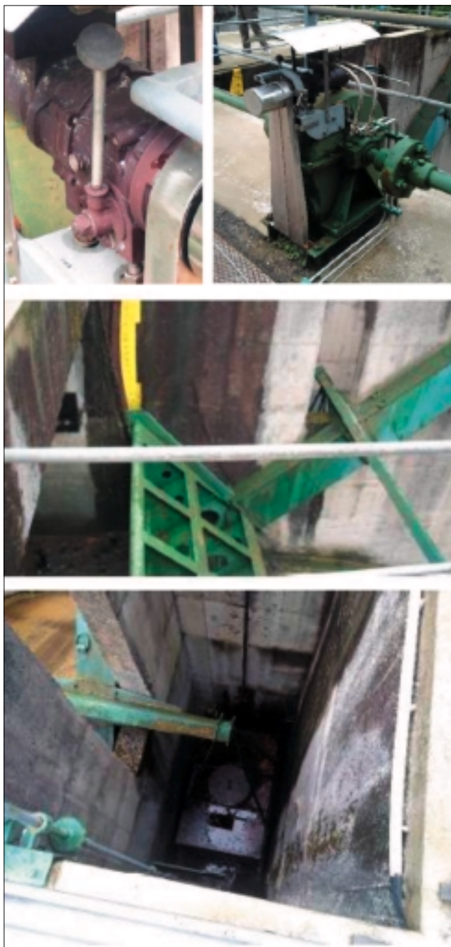
Figura 2 - Ante operam – argano a catena (sopra) e sistema di movimentazione (sotto).
