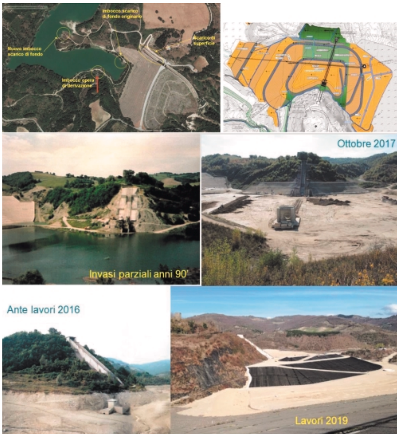
Figura 6 - Diga di Casanuova sul fiume Chiascio (PG) - Ubicazione e vista delle opere.
