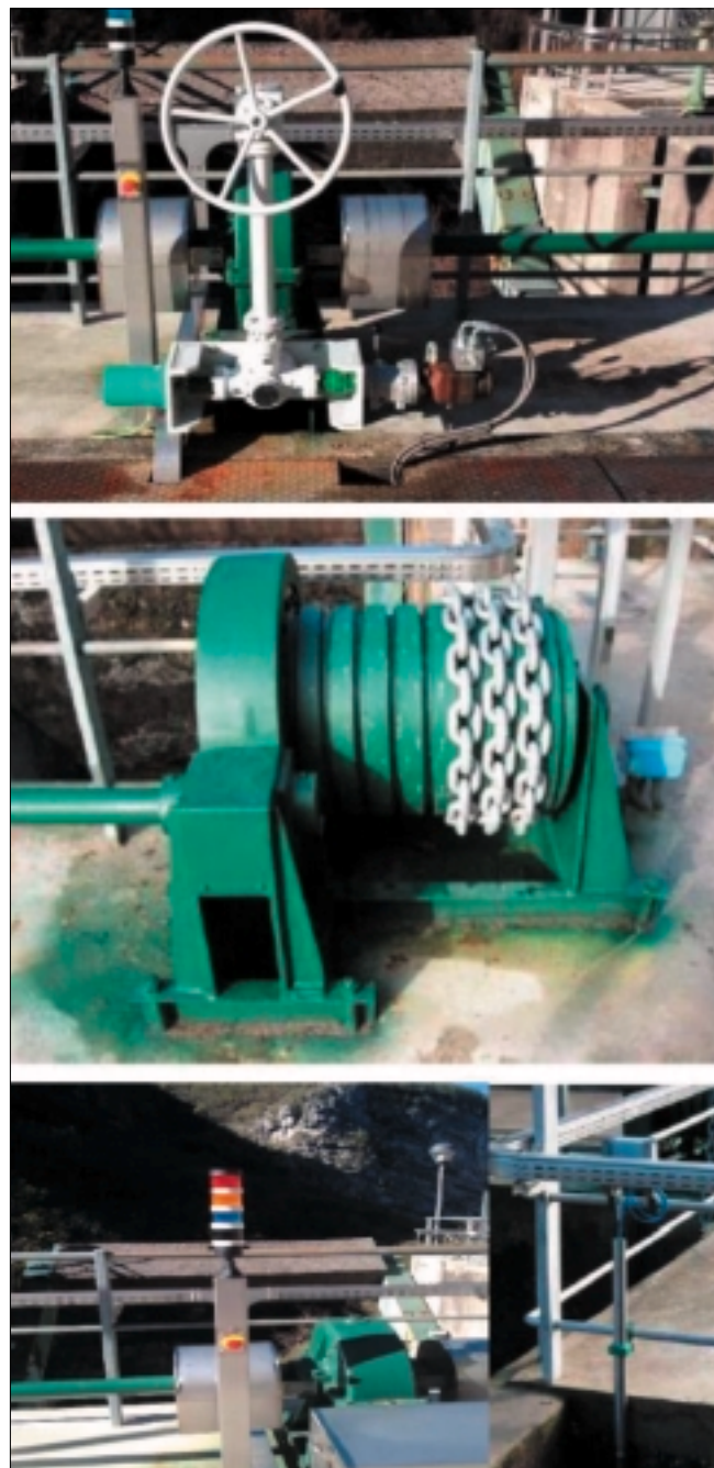
Figura 3 - Post operam – nuova movimentazione dell'argano a catena (sopra) e modifiche al sistema di regolazione e automazione (sotto).
