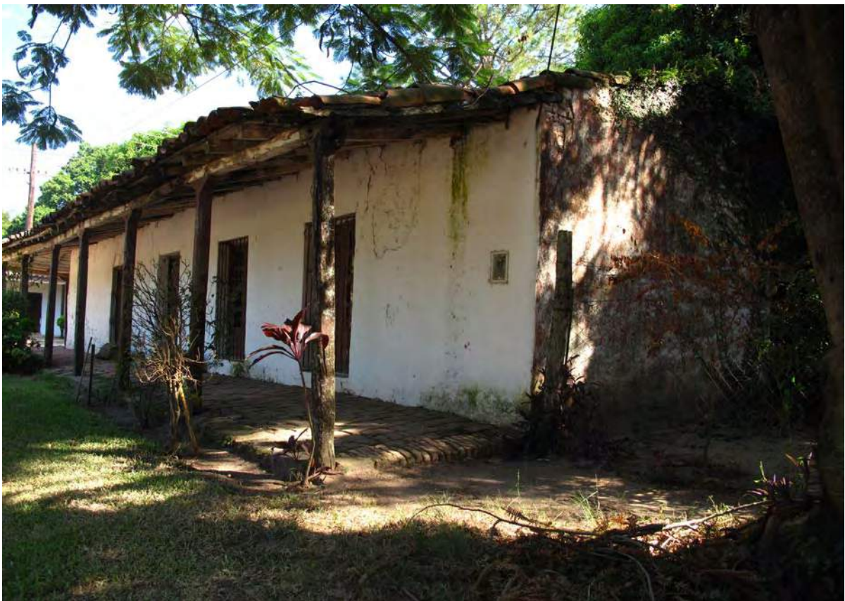
Figura 15. Alero pronunciado para la evacuación de lluvias y generación de sombras. Se aprecia en los muros de la vivienda la proliferación de hongos y algas debido a la elevada proporción de humedad ambiente (Procedencia gráfica: Díaz, I.).
