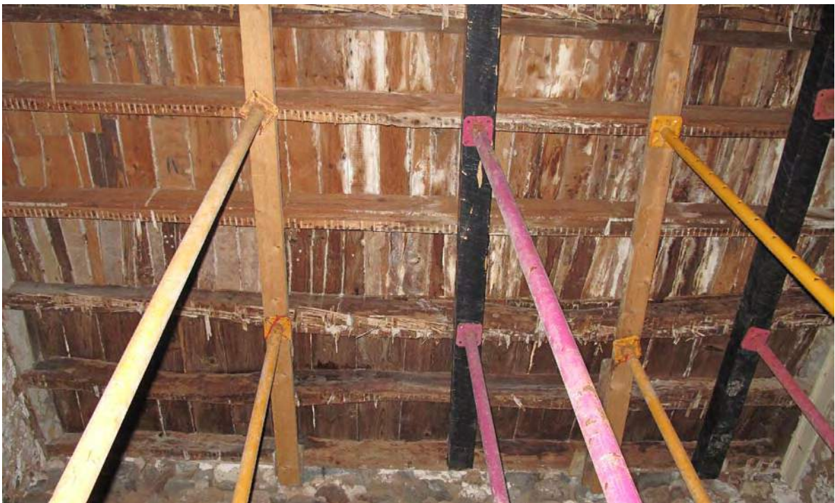
Figura VII.13. Cubierta apuntalada debido al débil estado de conservación en el que se encuentran de algunas de las vigas sostén del entramado de madera (Procedencia gráfica: Díaz, I.).
