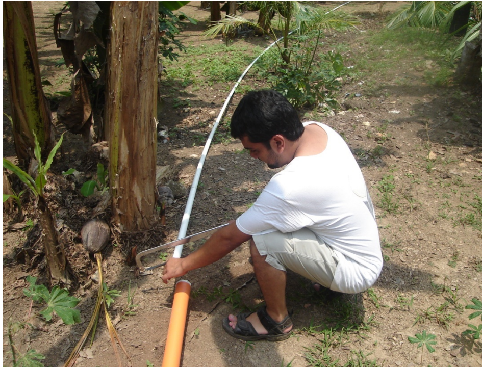
Figura No. 27 A. Sistema de conducción de agua hacia laboratorio
