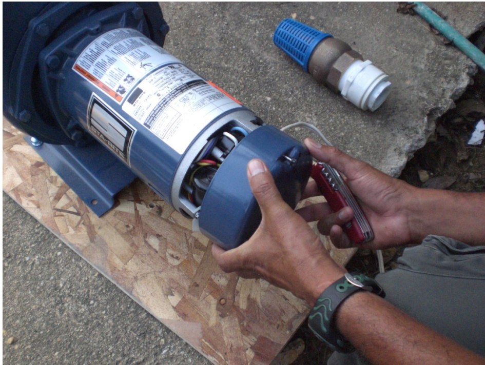
Figura No. 18 A. Fase de instalación del sistema de bombeo de laboratorio.
