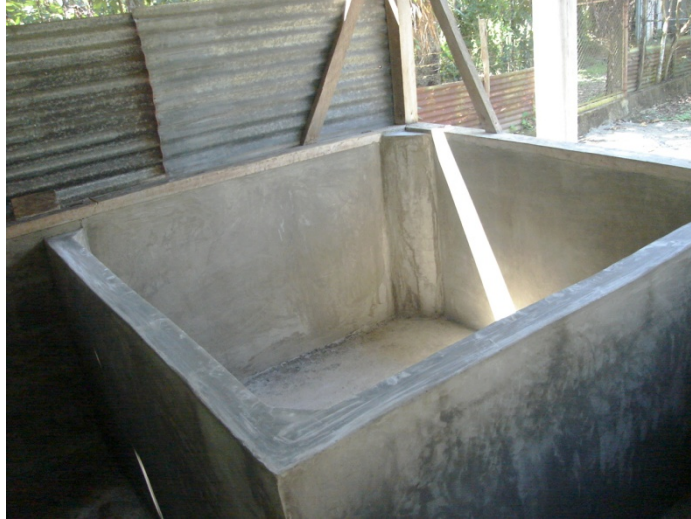
Figura No. 7 Estanque de acondicionamiento sin presencia de puntos muertos.
