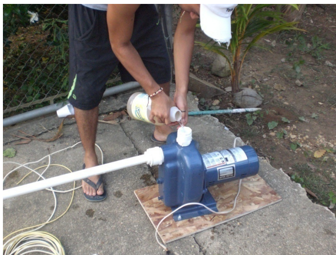
Figura No. 9 Sistema de conducción agua hacia los estanques.
