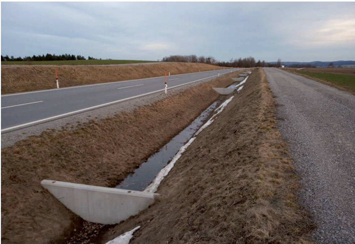
Figure 3.2.12.9. Recogida de agua en una zanja de la carretera (Foto T. Dostal).
