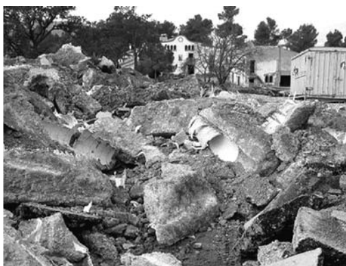
Els problemes en les obres són comuns en la majoria d'urbanitzacions
