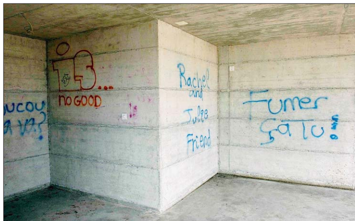
DÉPRÉDATIONS De nouveau, des tags ont été inscrits sur les murs du Centre sportif à Hauterive.
