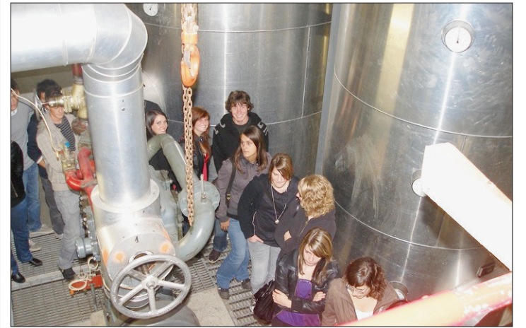
PATINOIRE Les installations frigorifiques devront être mises en conformité. (MICHEL BOURQUI)
