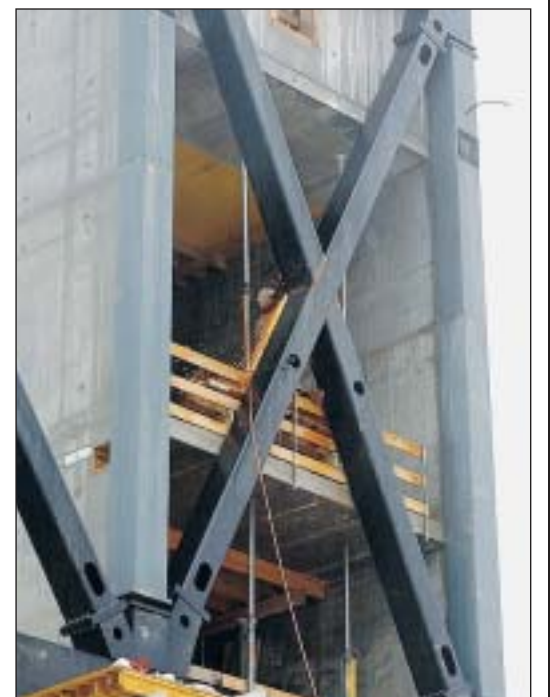
Les trois piliers en béton sont les seuls supports de la ferme-treillis. PHOTOS TEROL
