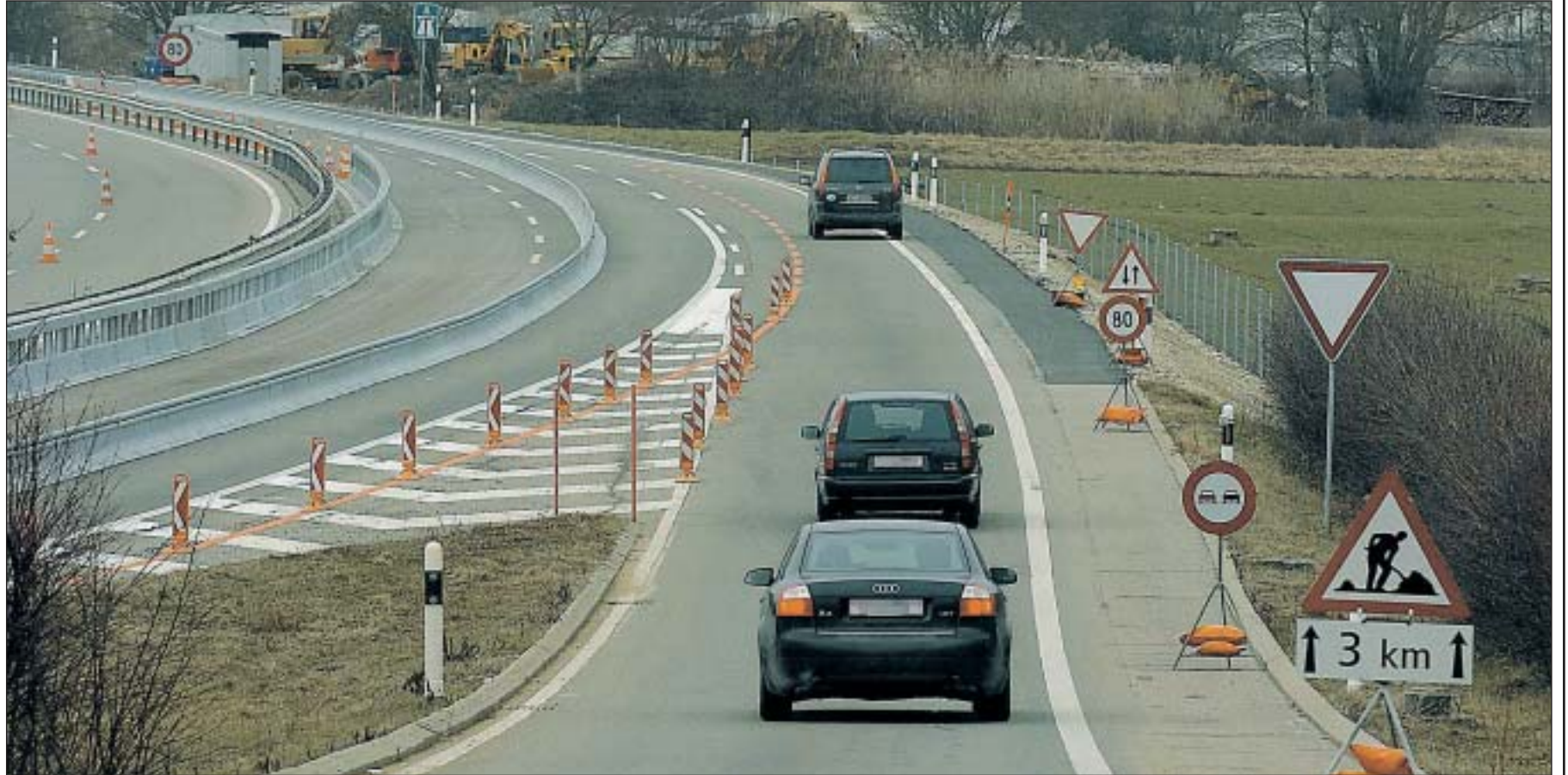
Depuis son installation la semaine passée, la zone de chantier entre Cornaux et La Neuveville a déjà été le théâtre de deux accidents de la circulation. Les automobilistes s'inquiètent du manque de visibilité dans le secteur. PHOTO LEUENBERGER
