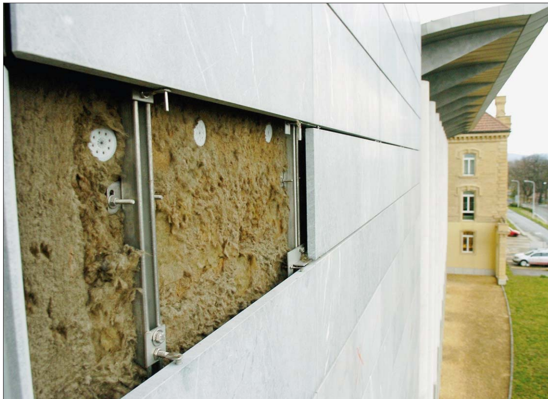
MARBRE DANGEREUX Le revêtement pierreux des façades ventilées d'Unimail présente des déformations. Les plaques menaçant de tomber ont été enlevées par mesure de précaution. (DAVID MARCHON)
