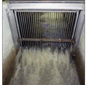
Eaux usées Un apport parasite d'eaux claires a été constaté à la step. (ARCHIVES DAVID MARCHON)
