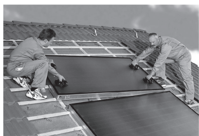
Une combinaison idéale: un chauffage au mazout et une installation solaire thermique. Le montage est simplifié par l'utilisation de composants modulaires.
