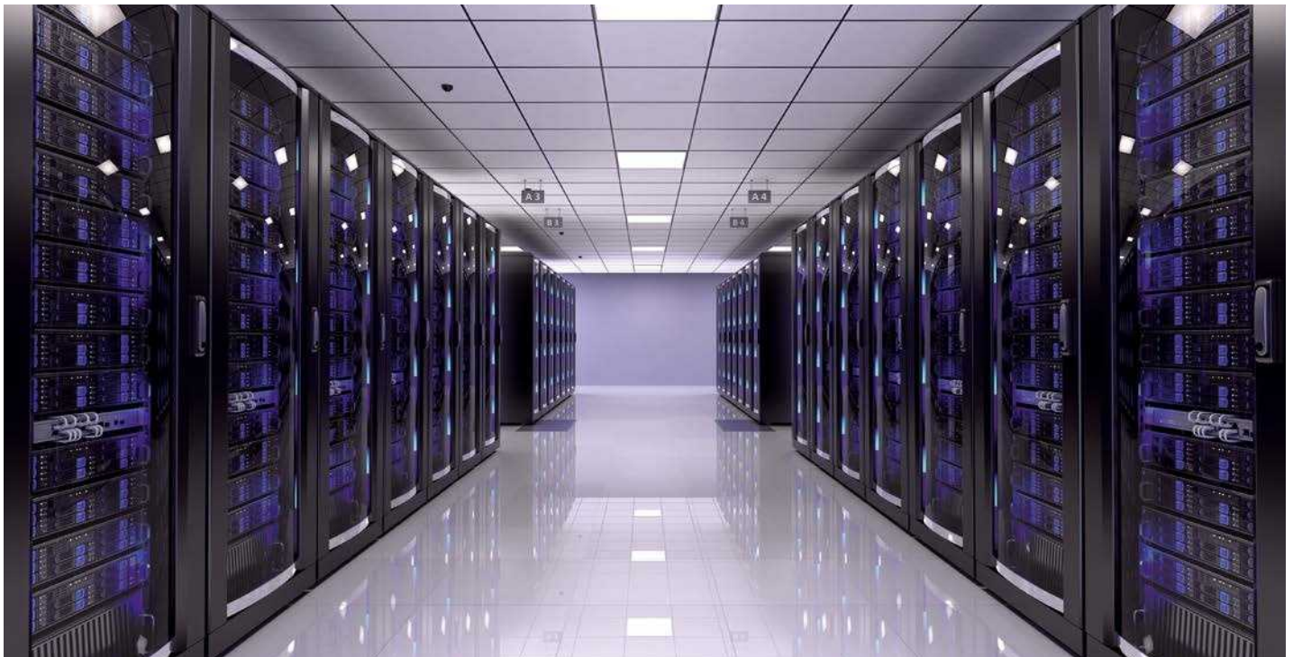
Abb. 68: Rechenzentrum mit einem Gleichspannungs-Stromversorgungssystem mit linearer Quellencharakteristik
