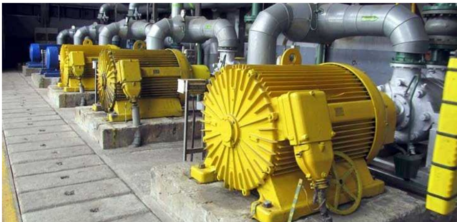
Abb. 2: Leistungsstarke Elektromotoren induzieren Überspannungen durch große Einschaltströme
