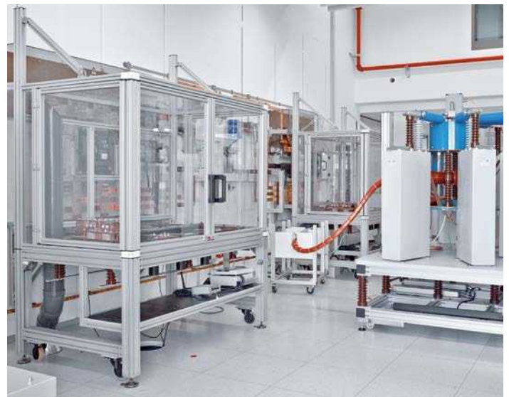
Abb. 25: Prüfplätze der Hochstromprüfanlage
