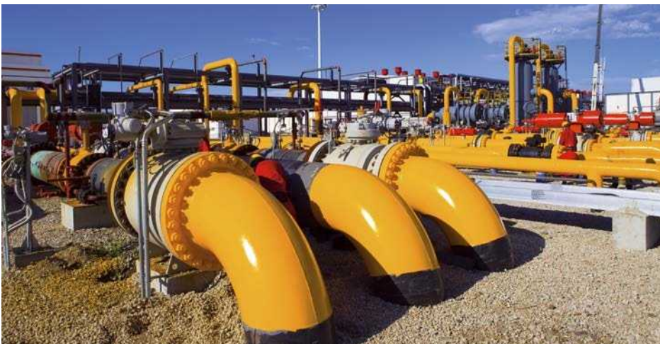
Abb. 96: Typisches Anwendungsfeld: Gasverdichterstation
