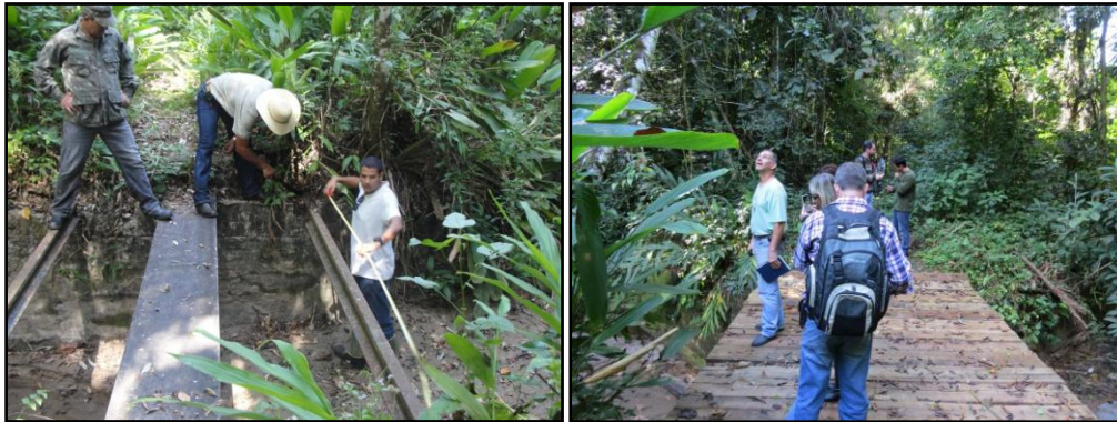
Figuras 57 e 58. Ponte sobre o córrego Águas Frias, à esquerda improvisada com pranchão; à direita após a restauração (Fotos de Márcia Porto e Rita Procópio).
