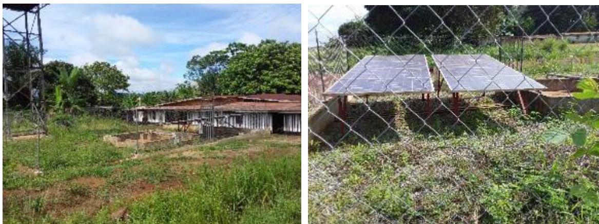
Photos 50 et 51 : Vues du château et des installations solaires du mini réseau d'adduction d'eau de Motobo 1
