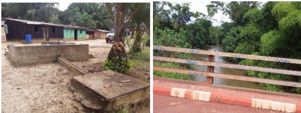
Photos 70 et 71 : Vues de la pompe hydraulique en panne et de la rivière Lekeye traversant la route sous le pont Source : BNETD, Enquête socio-économique, Octobre – Novembre 2019.
