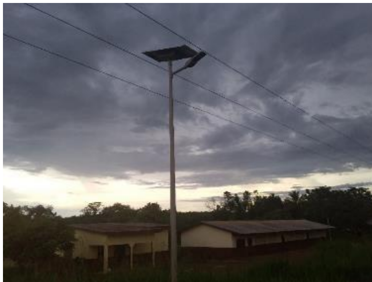
Photo 64 : Vue d'un lampadaire solaire sous la ligne HTA existant non fonctionnelle à Lekoussaga
