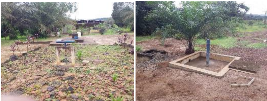
Photos 57 et 58: Vues de quelques installations du mini réseau d'adduction d'eau d'Okoloville Source : BNETD, Enquête socio-économique, Octobre – Novembre 2019.
