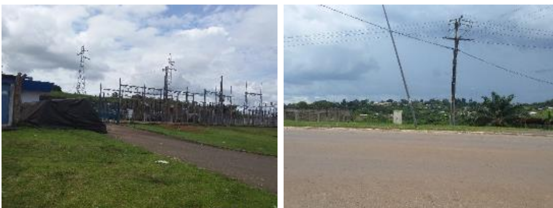
Photo 29 et photo 30: Vues du poste et réseau électriques riverains du projet dans le 4 ème Arrondissement de la Commune de Franceville
