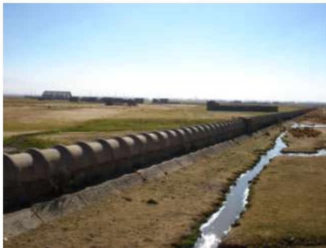
Foto 6. Emisario Planta de Puchukollo
