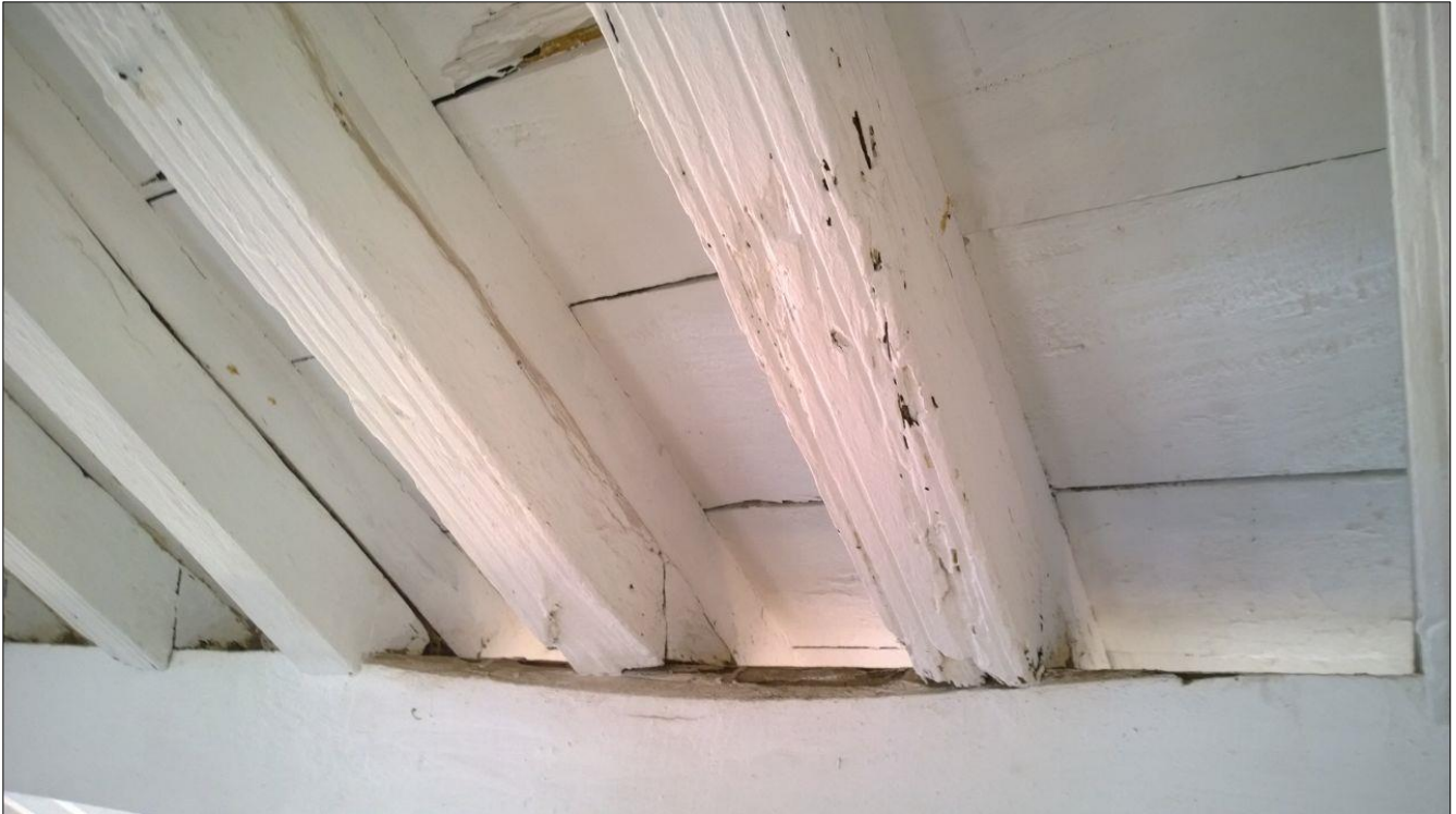
Foto #9. -Imagen donde se puede apreciar el ataque por comején (termitas) y polillas en los pares de la cubierta. También se puede apreciar en el segundo par (de derecha a izquierda) la galería eliminada de las termitas (R. Romero)
