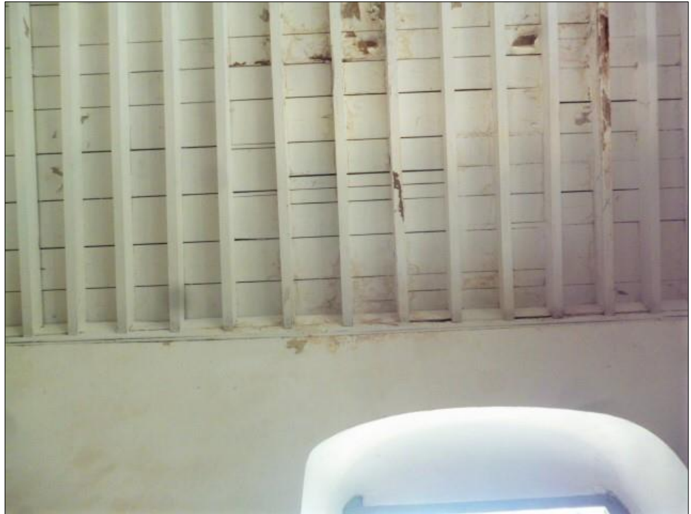
Foto #7.- Vista general de las patologías producidas por las filtraciones provenientes de la cubierta en la tablazón y los pares de la cubierta (D. Varela)
