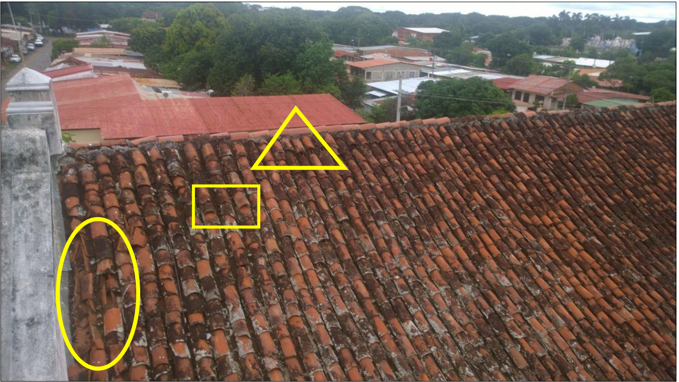
Foto #6.- Origenes de las filtraciones por la cubierta: 1. Rotura de tejas canales y cobijas (óvalo), 2.- Desplazamiento de tejas (triángulo), 3.-Mal traslape o encaje defectuoso (rectángulo) (Arq. R. Romero)
