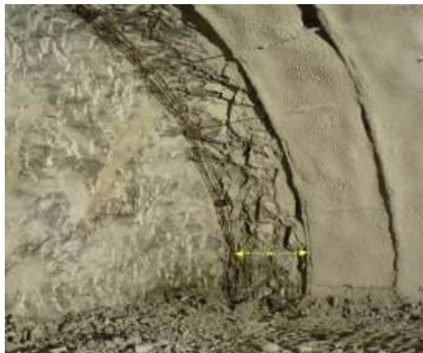
Σχήμα 1.13: Πτωχή ποιότητα βραχώμαζας – μικρό βήμα εκσκαφής
