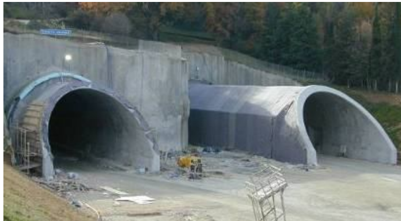
Σχήμα 1.22: Άποψη της τελικής επένδυσης στο τμήμα Cut & Cover. Εγνατία Οδός, Σήραγγα Δωδώνης
