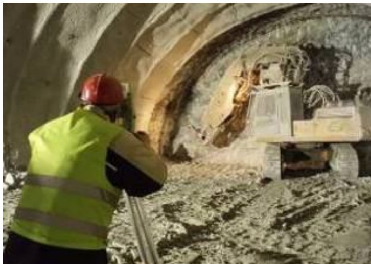
Σχήμα 2.16: Έλεγχος γεωμετρίας πλαισίου. Φαίνεται δικτυωτό πλαίσιο Lattice/Girder
