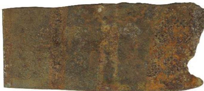
Εικόνα 4.8.2.24: Δείγμα συνδέσμου Σ.245 (όψη Α), μετά την αφαίρεση των επικαλυπτικών.
