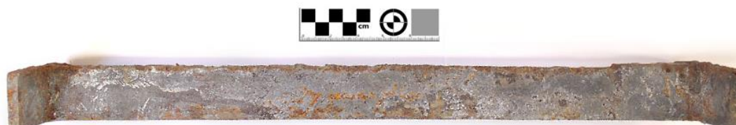
Εικόνα 4.1.11: Σύνδεσμος Σ.214 όψη Δ'.
