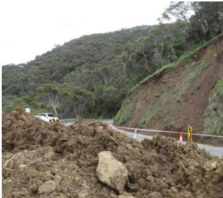
Εικόνα 2.13: Κατολίσθηση σε οδικό τμήμα του Great Ocean Road (Εικόνα από “The Landslide Blog”, 2016)
