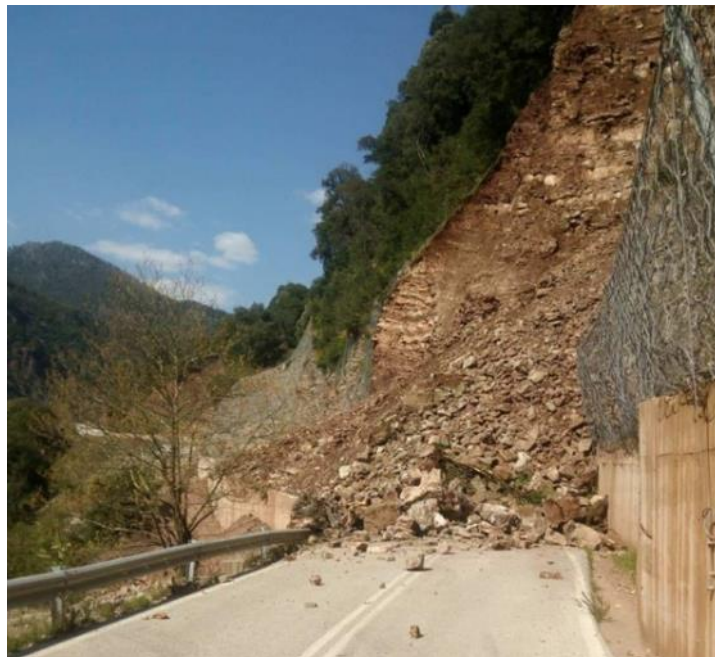
Εικόνα 2.11: Ροή κορημάτων μετά από βροχοπτώσεις στην επαρχιακή οδό Βαρβαριάδας - Αγράφων (Εικόνα από “vimapoliiti.gr”, 2020)
