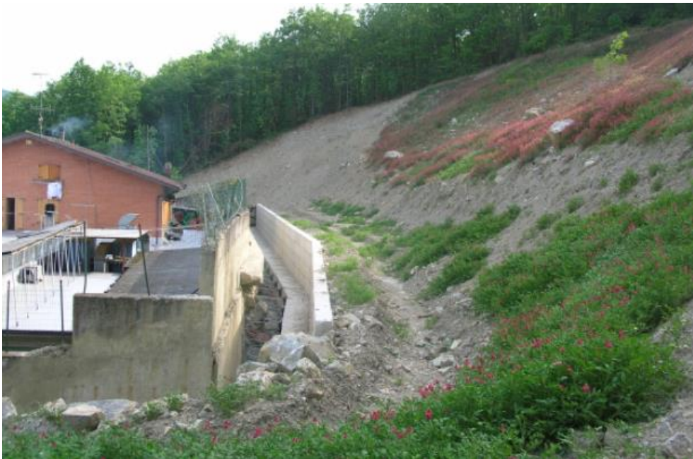
Εικόνα 2.16: Η διαμόρφωση του πρανούς και η χρήση τοίχου αναχαίτισης καταπτώσεων για την κατασκευή του “Al Boschetto Restaurant” (Castaldini)
