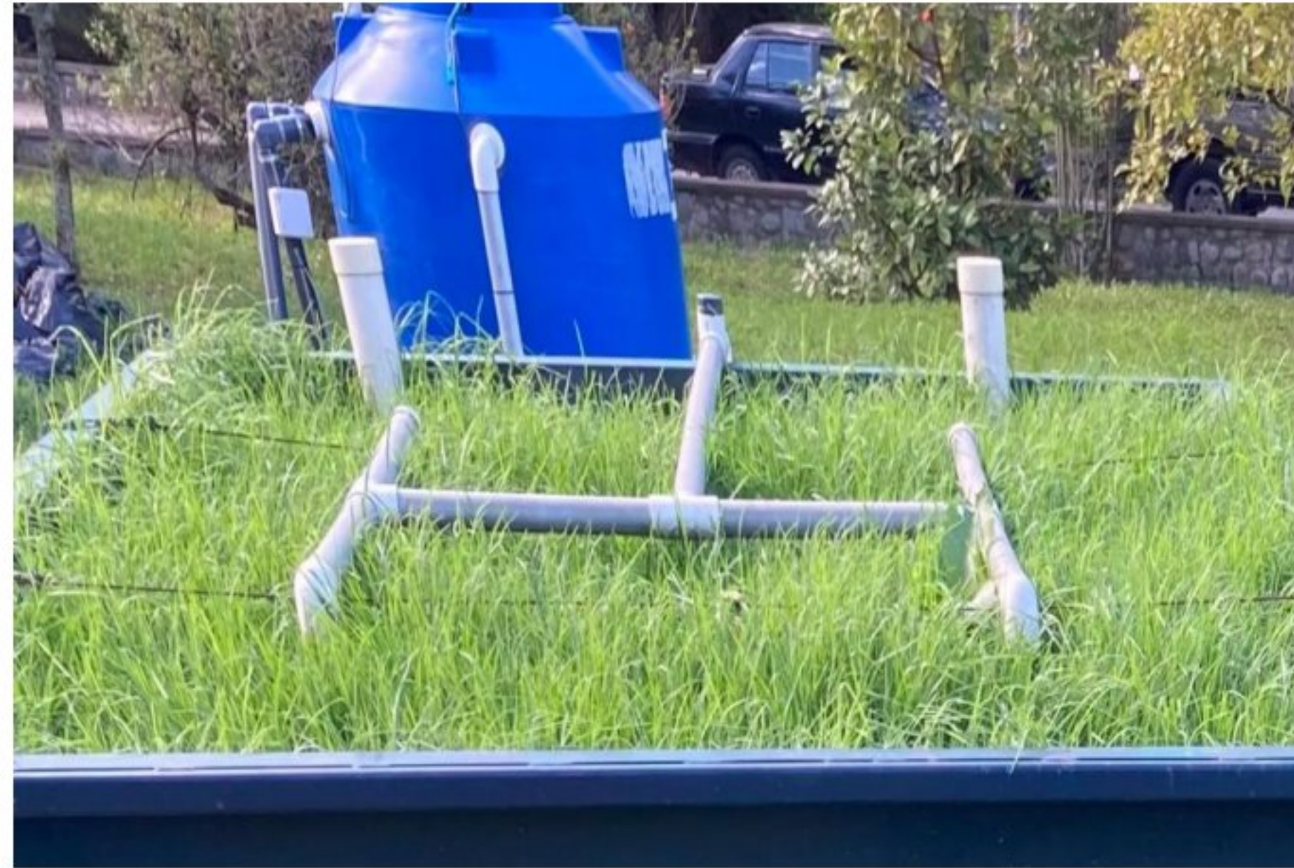
Figura 10: Tuberías de distribución de las aguas residuales.
