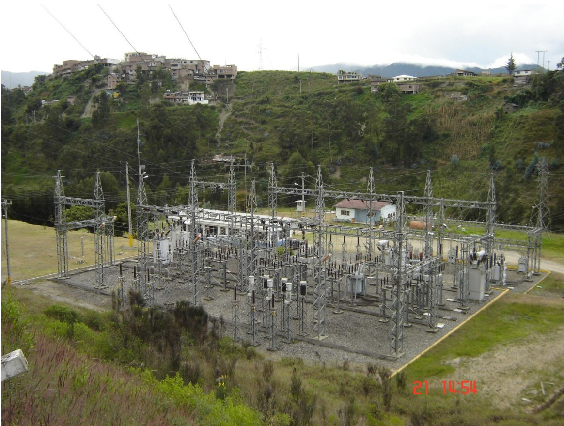
Figura 2 Subestación Obrapía, fuente EERSSA
