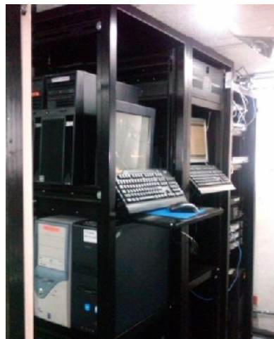
Figura 3.10: Cuarto de Telecomunicaciones – Edificio Matriz Fuente: Los autores, fotografía.
