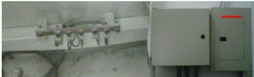
Figura 3.4: Sistema de Tierra para la COOPCCP Fuente: Los autores, fotografía.
