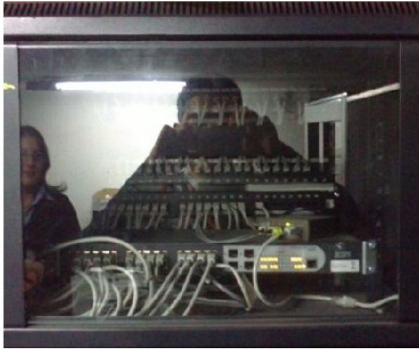
Figura 3.12: Racks ubicado en cuarto piso Fuente: Los autores, fotografía.
