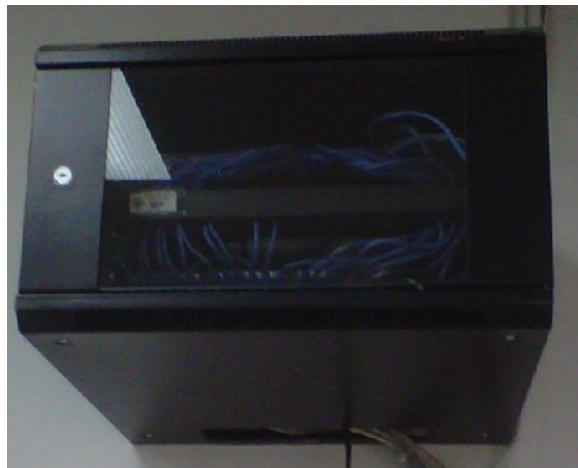
Figura 3.13: Racks ubicado en el segundo piso Fuente: Los autores, fotografía.
