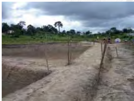
Photo E. Piquets lors de la construction des digues (Libéria) [© Y. Fermon].
