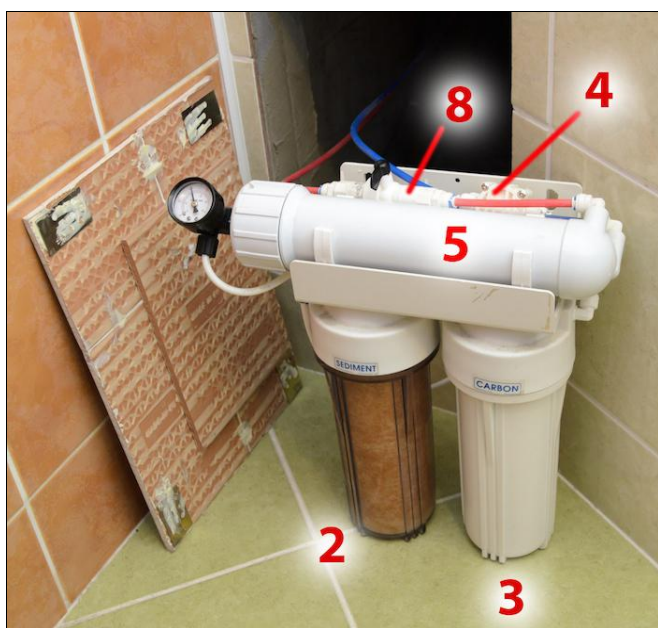
Filtračný systém s použitím 10" potrubných filtrov.
