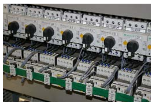
Die Motorstarter-Kombination PKZ M, DIL M und alle RMO-Drucktaster sind mit SmartWire-DT-Funktionsmodulen ausgestattet und über eine einzige grüne SmartWire-DT-Leitung miteinander verbunden.
