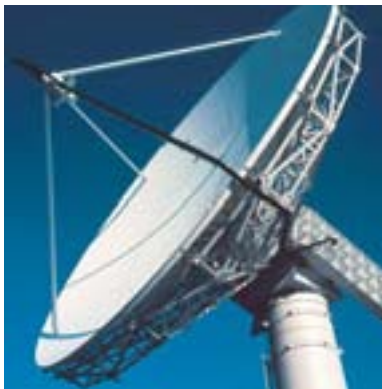
Antenne de télémessure (11 m) pour le Centre Spatial Sud-Coréen (NARO)
