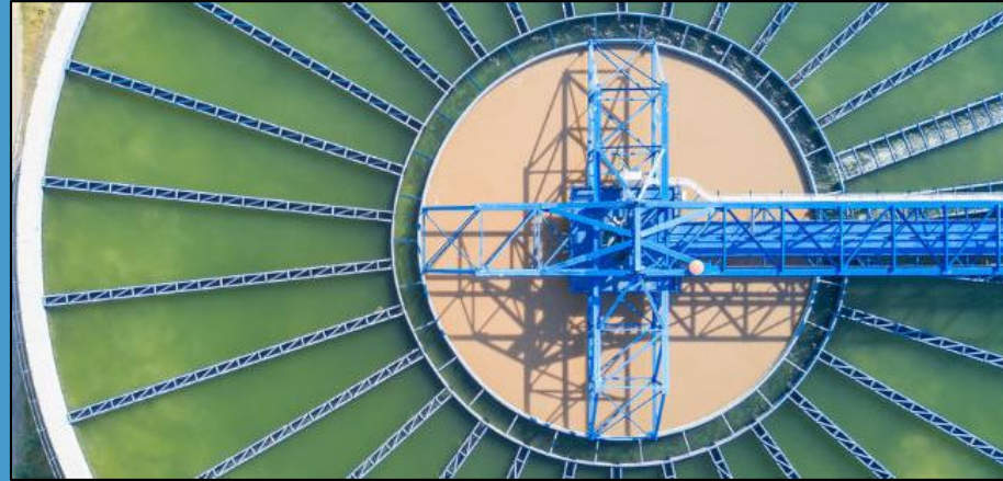
Μονάδα επεξεργασίας νερού, (aosts.com)
