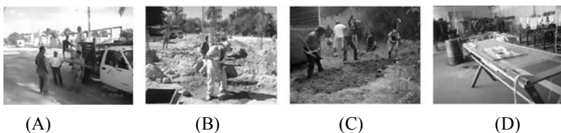
FIGURA 3.11. El trabajo obligatorio, las melgas: A) Melgas a cargo del Departamento de Agua Potable y Drenaje, B) Melgas a cargo del Departamento de Servicios Generales, C) Melgas a cargo del Departamento de Ecología y D) Melgas a cargo del Departamento de Programas Productivos
