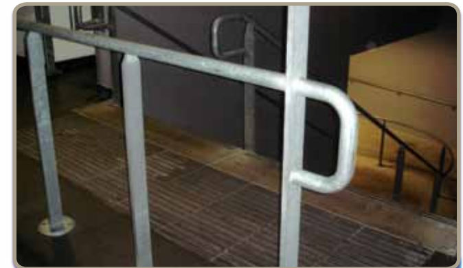
Figura 16 – Pavaj tactil (avertisment detectabil) cu o barieră la capătul scârilor
